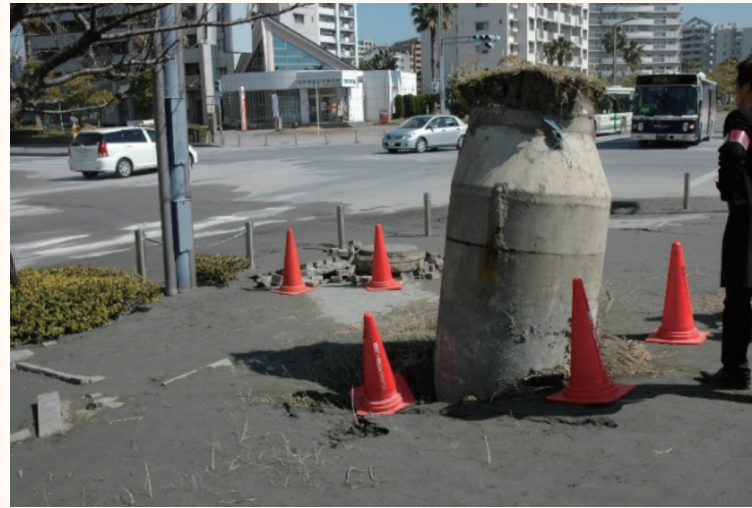
明海地区の突出したマンホール
